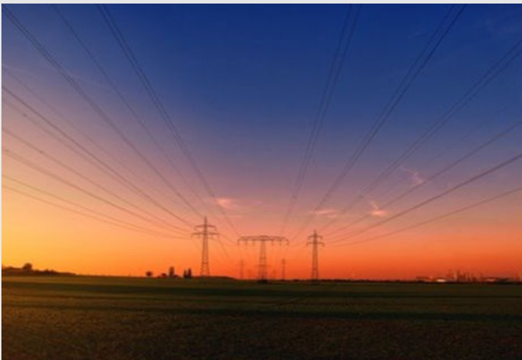
Líneas de alto voltaje
